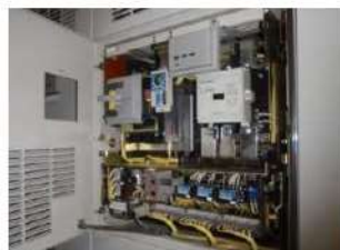
パワーコントロールセンタ
