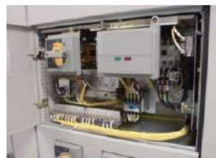
コントロールセンタ
