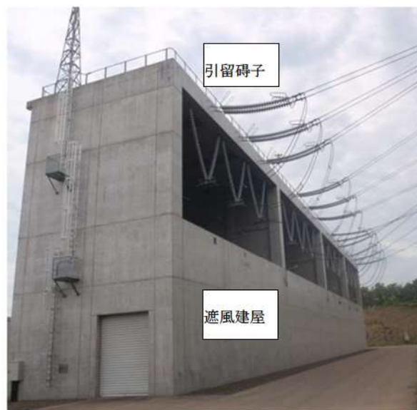
第 5.1 図 275kV 架線部 (引留碍子)
