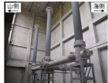
ポリマー碍管 (遮風建屋内)
