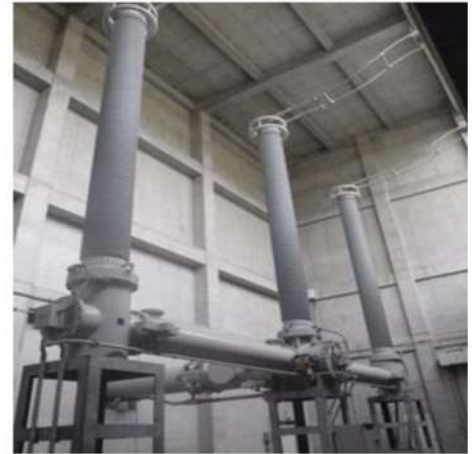
275kV ブッシング
