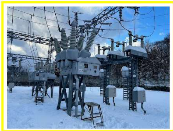
国富変電所（GCB）
