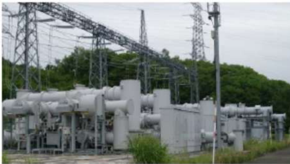
西野変電所（GIS）
