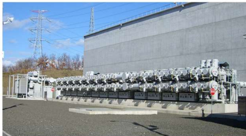
第 2.2.4.6 図 開閉所設備外観
