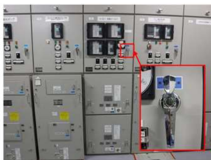
電源盤の施錠
