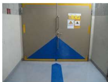
ドア・通路の識別 ユニットカラーによる識別 (1号炉：緑，2号炉：橙，3号炉：青)
