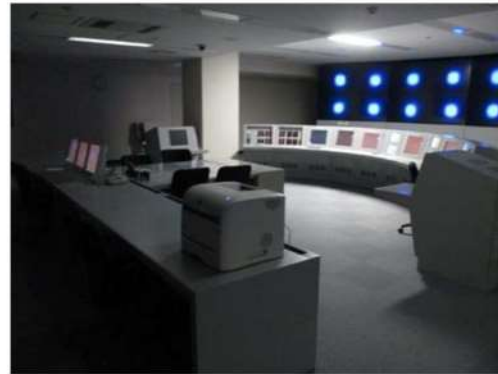
無停電運転保安灯点灯時
