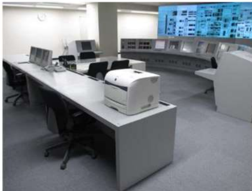
通常点灯時 (中央制御室非常用照明及び非常用照明)
