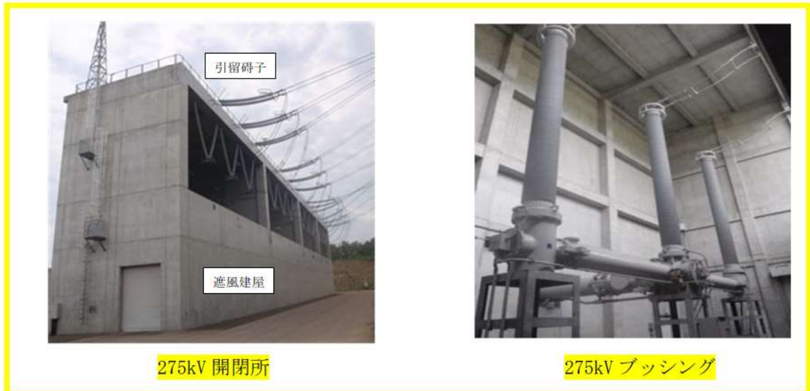
第 2. 2. 1. 11 図 送電線引込み部
