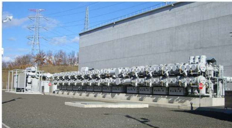
第 2.2.4.6 図 開閉所設備外観
