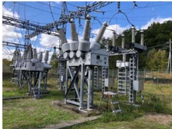
国富変電所（GCB）
