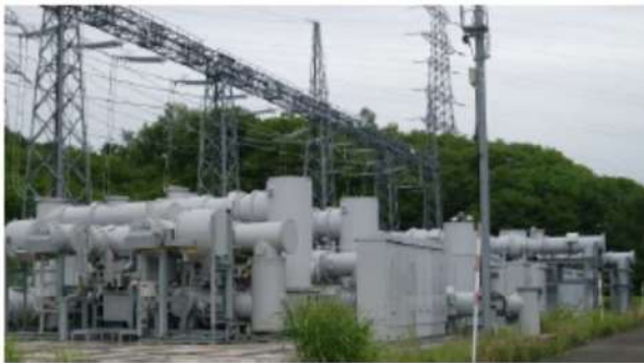
西野変電所（GIS）
