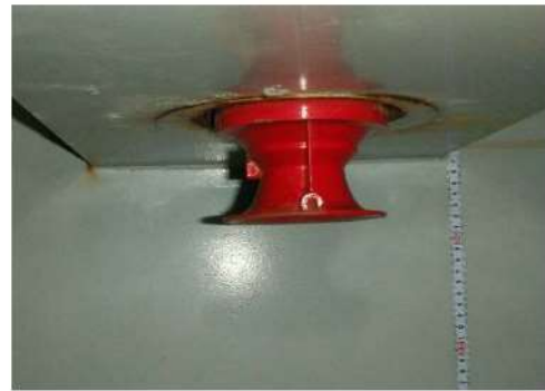
ポンプ部ベルマウス
