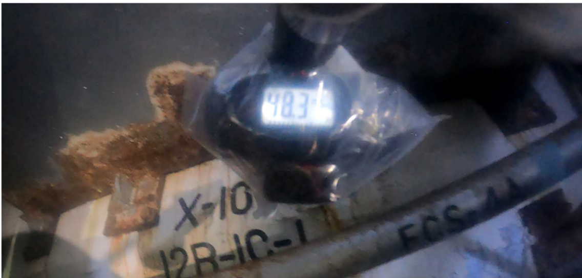
図 12 測定対象配管付近の線量率
