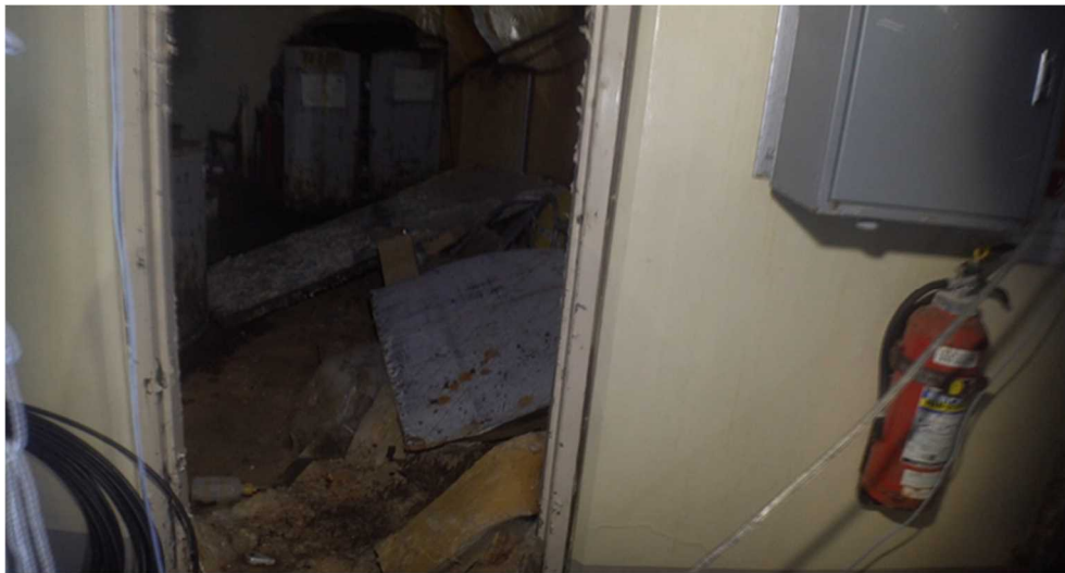
図5 1号機原子炉建屋3階東側の部屋（CRD リペア室）の状況 （室内に向かって扉等が破損している）
