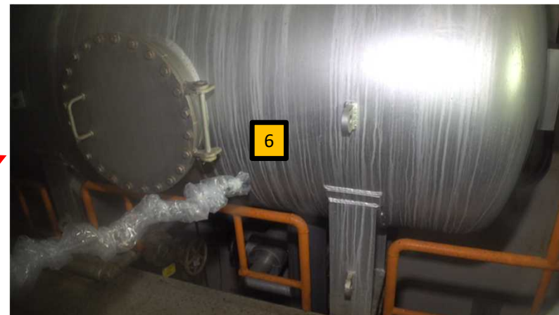
RCWサージタンク
