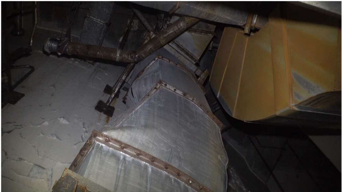
図 57 ダクト（北東側フロア）
