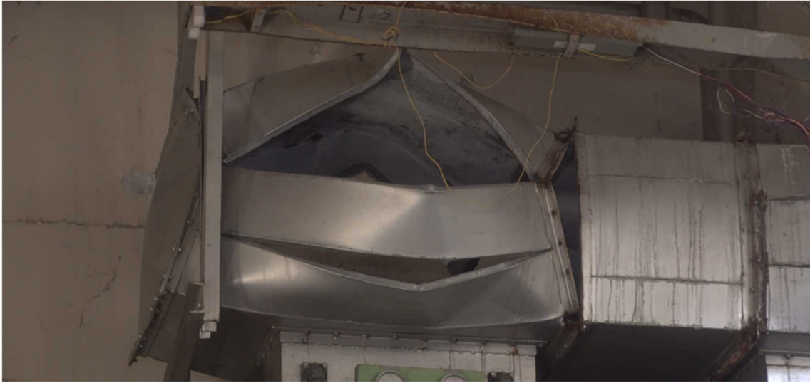
図 37 天井付近のダクト（1号機原子炉建屋4階）
