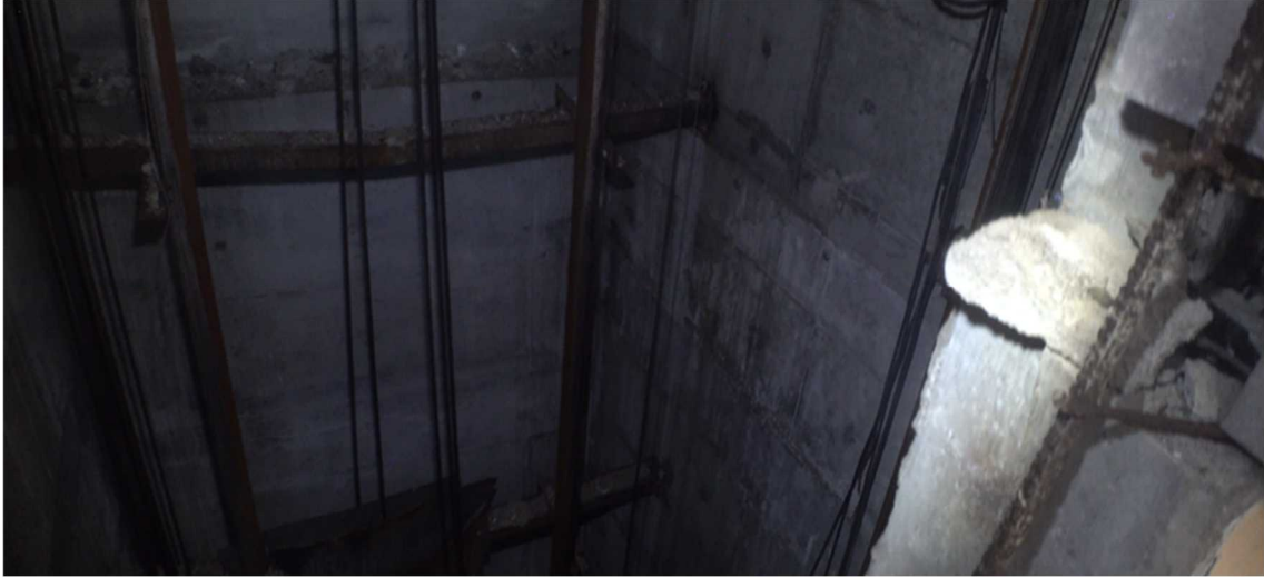
図 25 エレベータ室内（下方）（1号機原子炉建屋4階）
