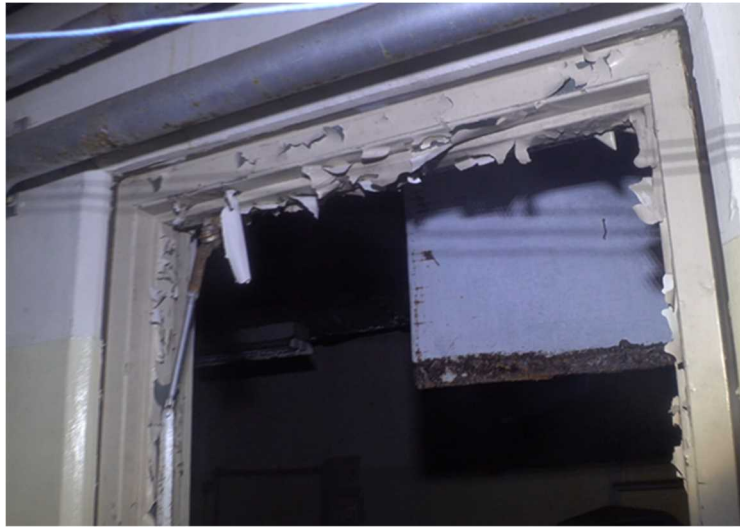
図4 1号機原子炉建屋3階東側の部屋（CRD リペア室）の入口付近の状況 （ドア枠上部）
