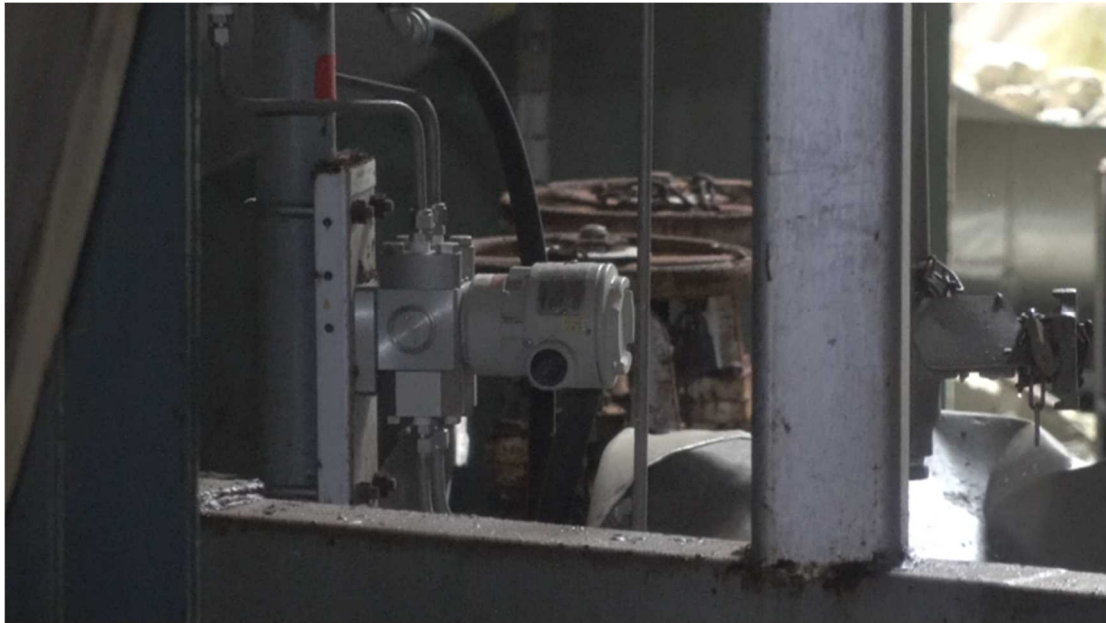
図 51 IC の A 系と B 系の間の計器類 (1 号機原子炉建屋 4 階)
