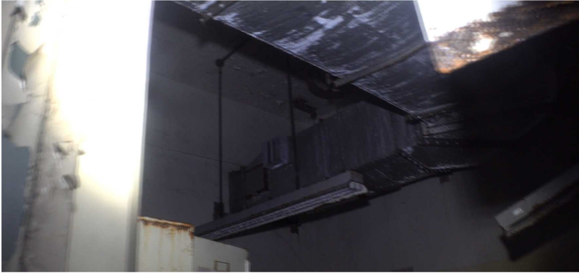
図6 1号機原子炉建屋3階東側の部屋（CRD リペア室）の状況 （部屋内部のダクト）
