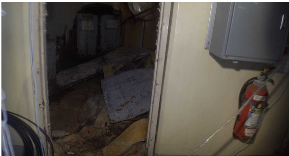
図5 1号機原子炉建屋3階東側の部屋（CRD リペア室）の状況 （室内に向かって扉等が破損している）
