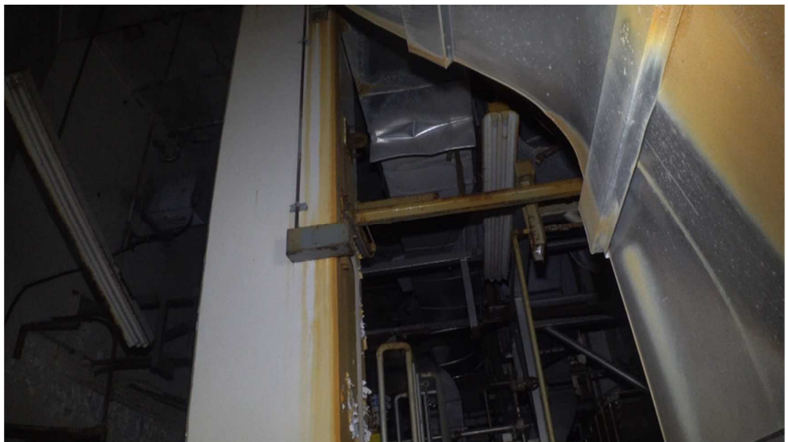
図 58 ダクト（北東側フロア）
