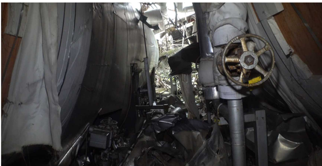
図 50 IC の A 系と B 系の間及び北側 (1 号機原子炉建屋 4 階)
