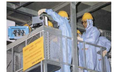
監視装置の保守管理
