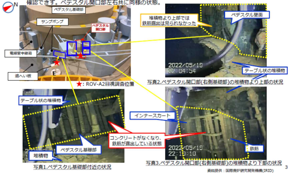
図8 ROV-A2 調査実績① ペDESTAL開口エリア (鉄筋露出有り)
