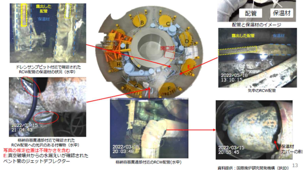
図 21-3 保温材の劣化
