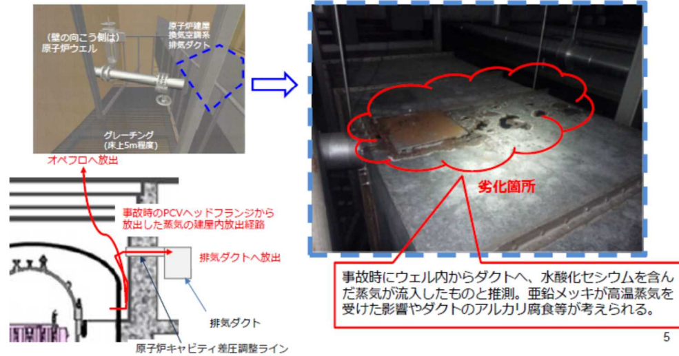
図6 2号機原子炉建屋換気空調系の排気ダクトの劣化（外観調査）
