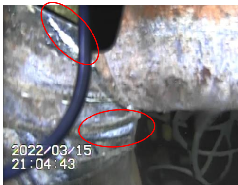
格納容器貫通部付近で確認されたRCW配管への光沢のある付着物 (水中)
