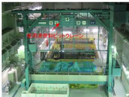
使用済燃料ピットクレーン
