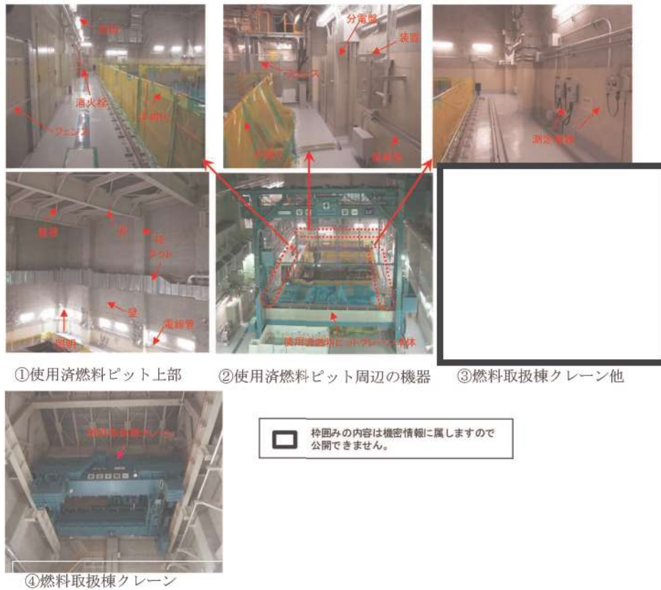
図 3.2.1 泊発電所 3 号炉 使用済燃料ピット周辺 概要
