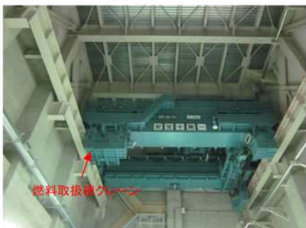
燃料取扱棟クレーン
