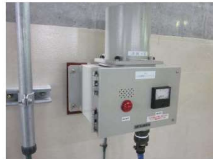
機器の固定状況
