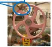
加圧器ベントライン 【3-加圧器ベント弁 (3V-RC-053)】
