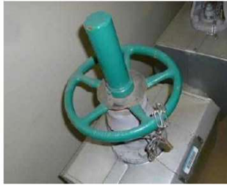
図2 弁施錠状態の例
