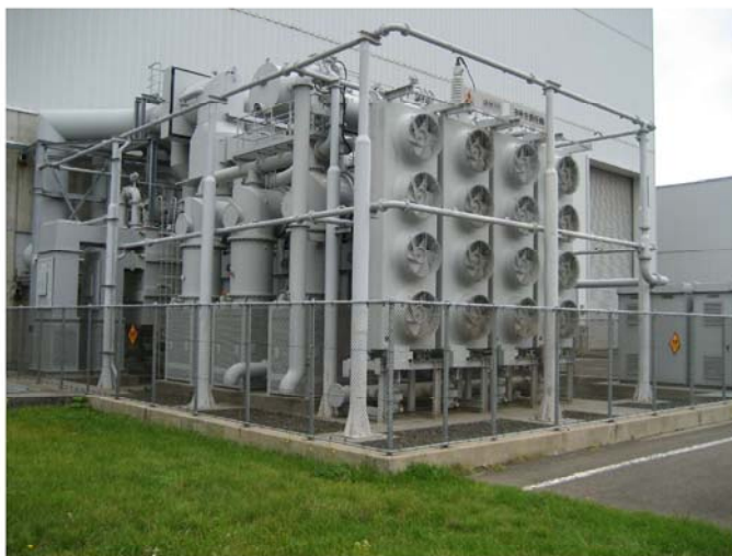
第1図 変圧器外観
