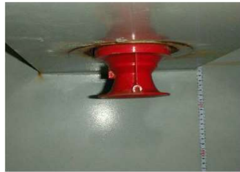
ポンプ部ベルマウス
