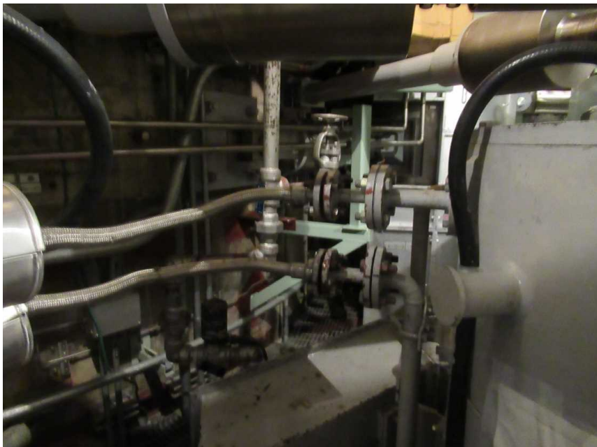
原子炉再循環ポンプ モータ潤滑油配管
