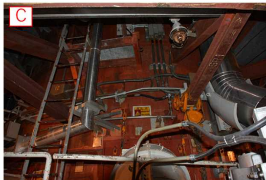
金属保温材 (再循環配管廻り)
