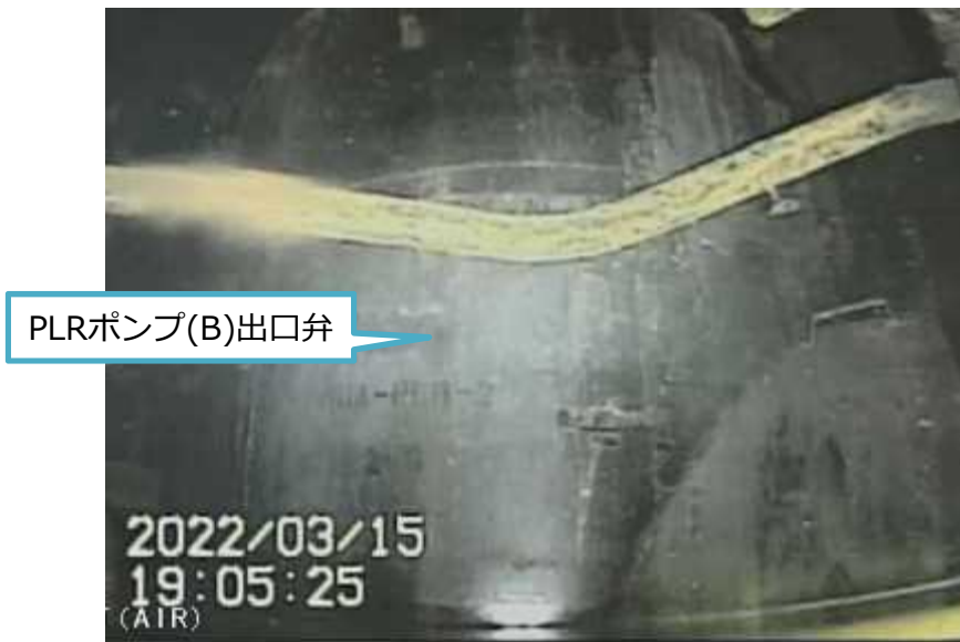
写真1. PLRポンプ(B)出口弁付近の状況
