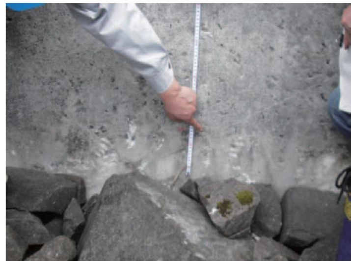
写真-5.23 リップラップと洪水吐き導流壁との隣接部のロック部の沈下痕跡
