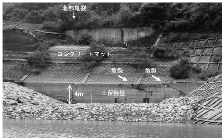
写真-2 土留擁壁への亀裂 右端のリップラップの盛り上がりは施工当時のもの。
