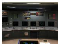
既設照明兼非常用照明点灯時のイメージ (写真：シミュレータ撮影)
