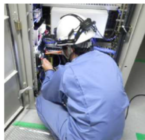
バッテリー繋ぎ込み 原子炉補助建屋（T.P.17.8m）
