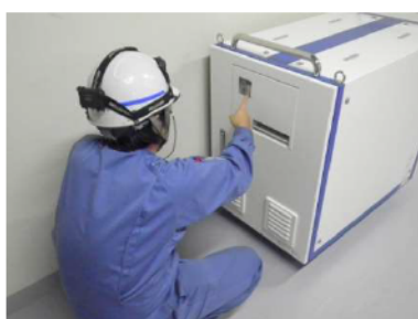
可搬型バッテリー 原子炉補助建屋（T.P.17.8m）
