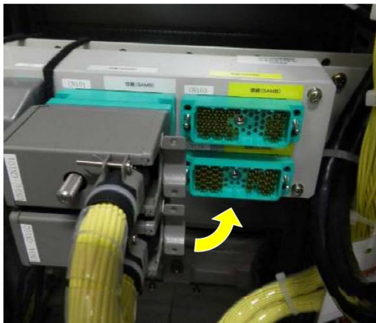
(1次系制御監視盤内 切替器)
