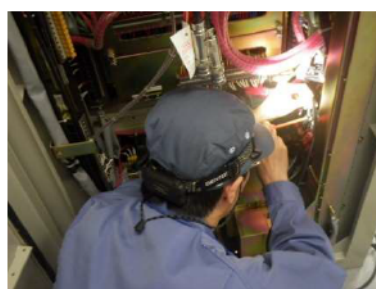
バッテリー繋ぎ込み 原子炉補助建屋（T.P.17.8m）
