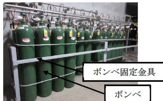
【3号機タービン建屋】 液化炭酸ガス (発電機水素置換用)
