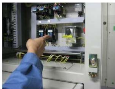
代替非常用発電機受電遮断器操作 （安全補機開閉器室） （原子炉補助建屋T. P. 10. 3m）
