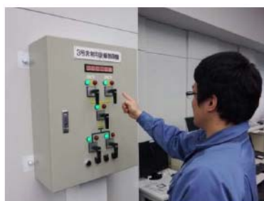
3号非常用受電設備遮断器操作 （中央制御室） （原子炉補助建屋T.P. 17. 8m）
