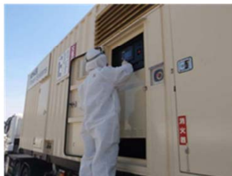
可搬型代替電源車起動 (屋外T. P. 31m)
