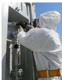
代替非常用発電機の給油口に 給油ガン接続 (代替非常用発電機) (屋外 T.P. 31m)
