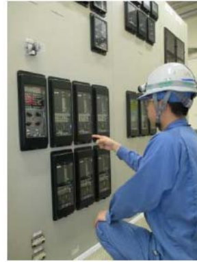
保護リレーロック操作 (1号機 2次系継電器室) (原子炉建屋 T.P. 10.3m)
