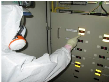
不要直流負荷切離し操作 （安全補機開閉器室） （原子炉補助建屋 T.P. 10. 3m）
