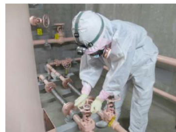
燃料汲み上げ系統構成 (ディーゼル発電機燃料油サービスタンク室) (原子炉建屋T.P. 17. 8m)
