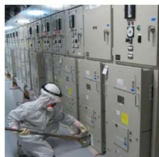
受電遮断器操作 （安全補機開閉器室） （原子炉補助建屋T.P. 10. 3m）
