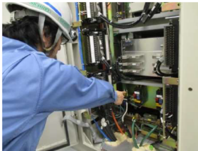
不要直流負荷の切離し操作 (安全系計装盤室) (原子炉補助建屋 T.P. 17.8m)
