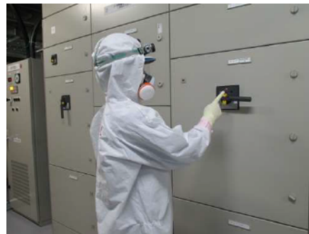
可搬型直流電源用発電機及び 可搬型直流変換器による受電操作 （安全補機開閉器室） （原子炉補助建屋 T.P. 10. 3m）
