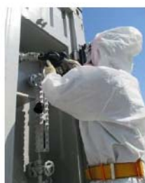
代替非常用発電機の給油口に 給油ガン接続 (代替非常用発電機) (屋外 T.P. 31m)
