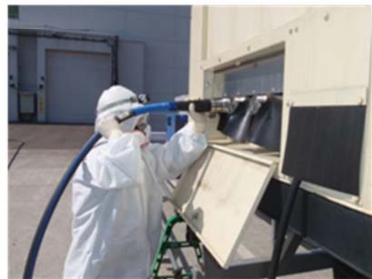
高圧ケーブル接続 (屋外T. P. 31m)
