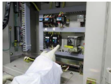
受電遮断器操作 （安全補機開閉器室） （原子炉補助建屋T.P. 10. 3m）
