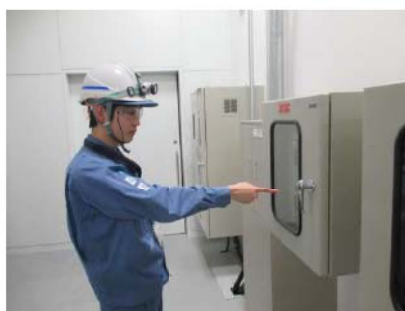
後備蓄電池による受電操作 （中央制御室） （原子炉補助建屋 T.P. 17.8m）
