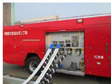
可搬型大型送水ポンプ車 周辺のホース敷設 (屋外 T. P. 10m)
