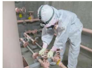
系統構成 (ディーゼル発電機燃料油サービスタンク室) (原子炉建屋 T.P. 17.8m)
