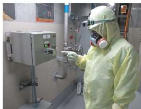
1次系補給水ポンプによる補給 (原子炉補助建屋 T.P. 17.8m)
