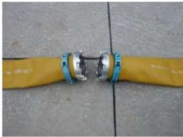
可搬型ホース(150A)接続口
