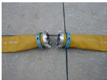
可搬型ホース (150A) 接続口
