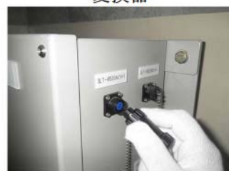
ケーブル接続 BOX
