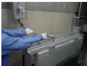
空冷配管との接続
