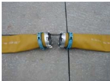
可搬型ホース (150A) 接続口
