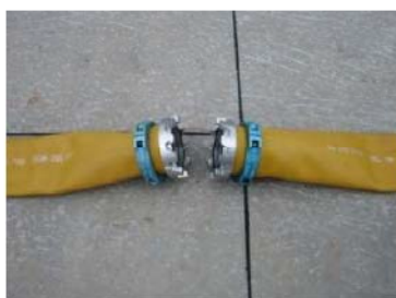
可搬型ホース (150A) 接続口
