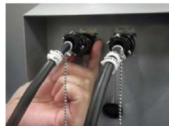
検出器用ケーブル接続
