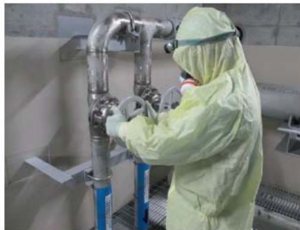
燃料取替用水ポンプによる注水系統構成 (原子炉建屋 T.P. 10. 3m)
