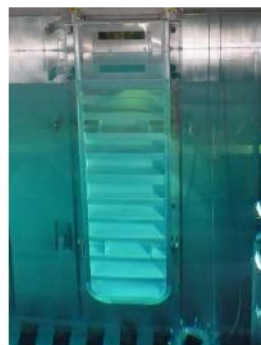
ゲートの設置状況
