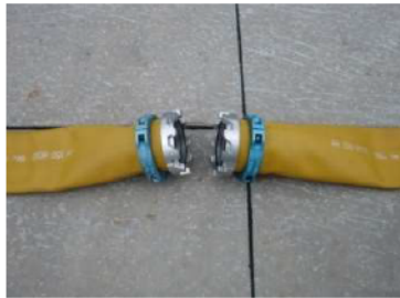
可搬型ホース(150A)接続口
