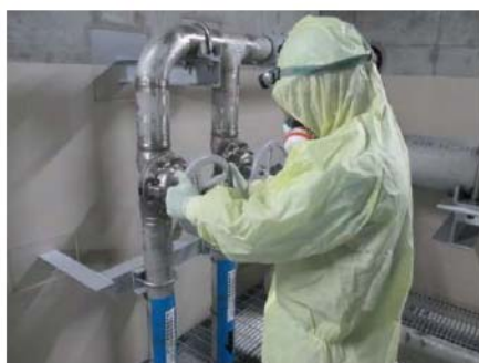
2次系補給水ポンプによる 注水系統構成 (原子炉建屋 T.P. 10. 3m)
