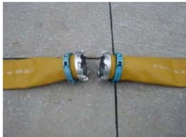
可搬型ホース (150A) 接続口
