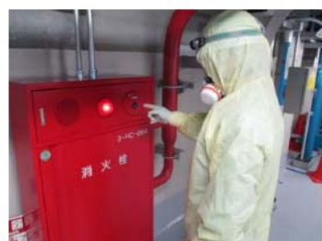
消火ポンプ起動 (原子炉建屋 T.P. 33. 1m)
