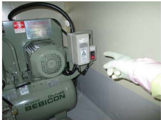
可搬型代替ガスリンク圧縮装置起動 (原子炉建屋 T.P. 24.8m)
