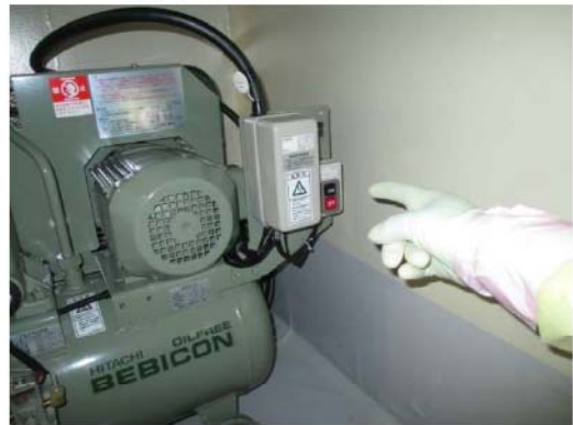
可搬型代替ガスサブリング圧縮装置起動 (原子炉建屋 T.P. 24.8m)
