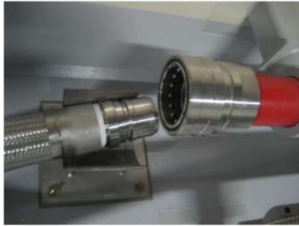
消火水系統と格納容器スプレイ系統の 接続のためフレキシブル配管接続口 (運転員(現場)①) (原子炉補助建屋 T.P. 10.3m)
