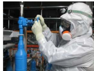
原子炉補機冷却水系統加圧操作 (原子炉建屋 T.P. 46.2m)
