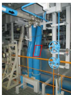
可搬型温度計測装置設置場所（供給側） （原子炉建屋 T.P. 14. 3m）
