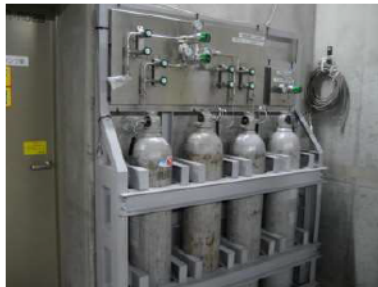
原子炉補機冷却水サージタンク 加圧用可搬型窒素ガスボンベ (原子炉建屋 T.P. 43.6m)
