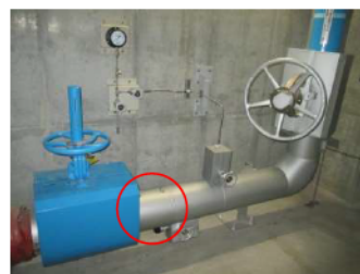
可搬型温度計測装置設置場所（排水側） （原子炉建屋 T.P. 17. 8m）
