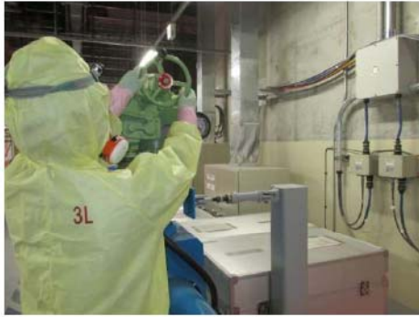
格納容器隔離弁閉止操作 (原子炉建屋 T. P. 24. 8m)
