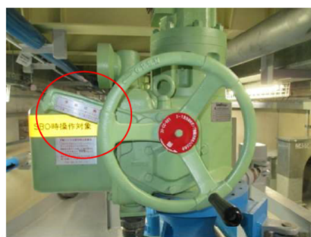
電動弁（手動操作レバー）
