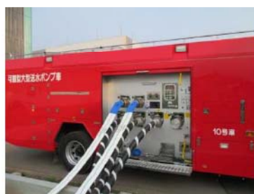
可搬型大型送水ポンプ車 周辺のホース敷設 (屋外 T. P. 31m)
