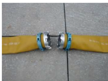
可搬型ホース(150A)接続口
