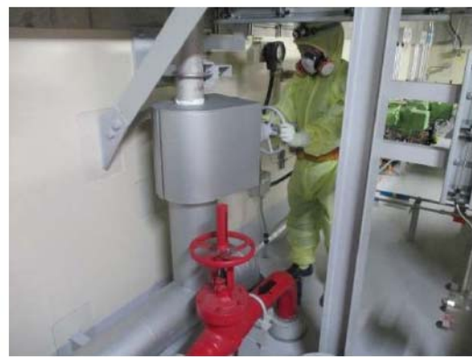
代替格納容器スプレイポンプ系統構成 (原子炉補助建屋 T.P.10.3m)
