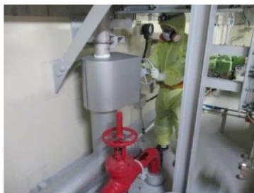
原子炉への注水ライン 系統構成 (運転員（現場）①) (原子炉補助建屋 T.P. 14.5m)
