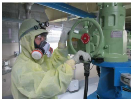
1次冷却材ポンプ封水ライン隔離弁 閉止操作 (原子炉建屋 T.P. 21. 2m)
