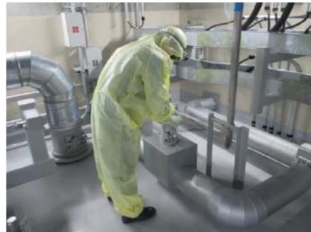
R H R S - C S S 連絡ライン手動弁操作 (原子炉補助建屋 T.P. 14.5m)
