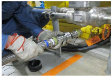
ホース接続操作 (油タンク側) (タービン動補助給水ポンプ室 T. P. 10. 3m)
