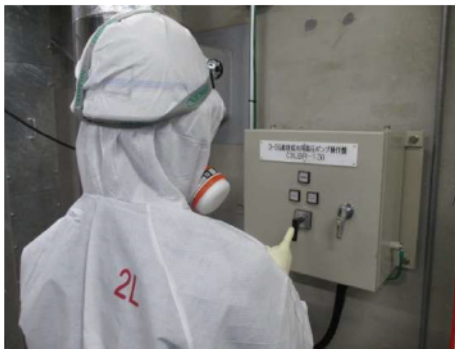
S G 直接給水用高圧ポンプ起動操作 (原子炉建屋 T. P. 24. 8m)
