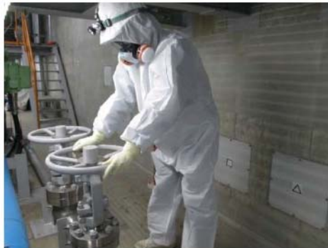
可搬型大型送水ポンプ車による 蒸気発生器への注水系統構成 (原子炉建屋 T.P. 29.3m)
