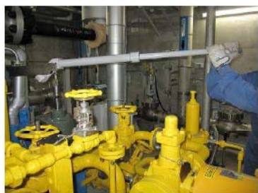
起動用レバー操作 (タービン動補助給水ポンプ室 T. P. 10. 3m)
