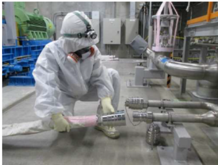
フレキシブル配管接続 (原子炉建屋 T.P. 24. 8m)
