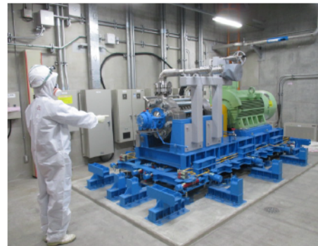
S G 直接給水用高圧ポンプ (原子炉建屋 T. P. 24. 8m)
