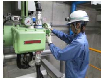
タービン動補助給水ポンプ 駆動蒸気入口弁「開」操作 (タービン動補助給水ポンプ室 T. P. 14. 3m)
