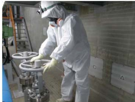
可搬型大型送水ポンプ車による 蒸気発生器への注水系統構成 (原子炉建屋 T.P. 29.3m)
