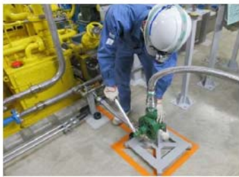
潤滑油供給操作 (タービン動補助給水ポンプ室 T. P. 10. 3m)
