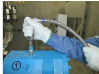
ホース接続操作 (軸受側) (タービン動補助給水ポンプ室 T. P. 10. 3m)
