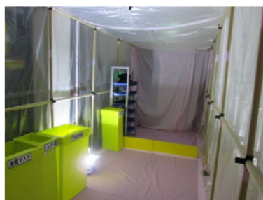
可搬型照明①
