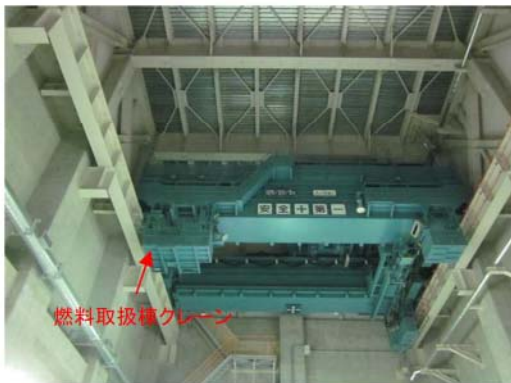
燃料取扱棟クレーン
