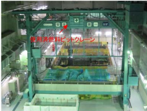
使用済燃料ピットクレーン
