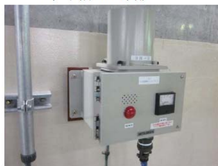
機器の固定状況
