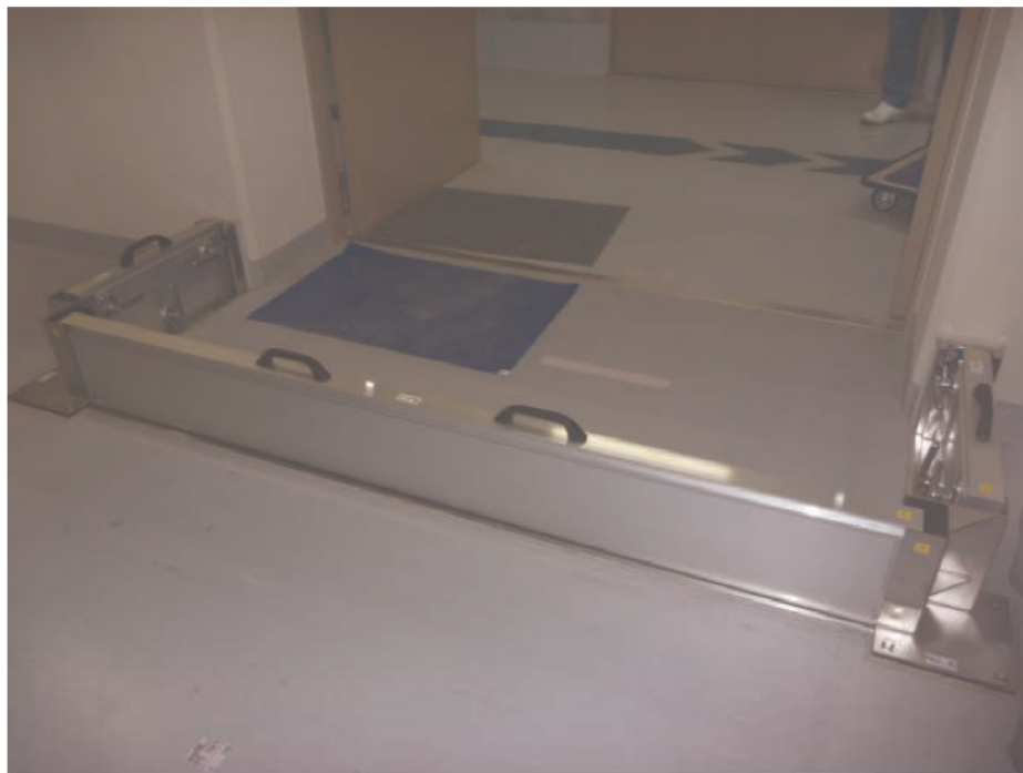
参考資料 1 添付 1-図 2 止水版写真（1次冷却材ポンプ母線計測盤室）
