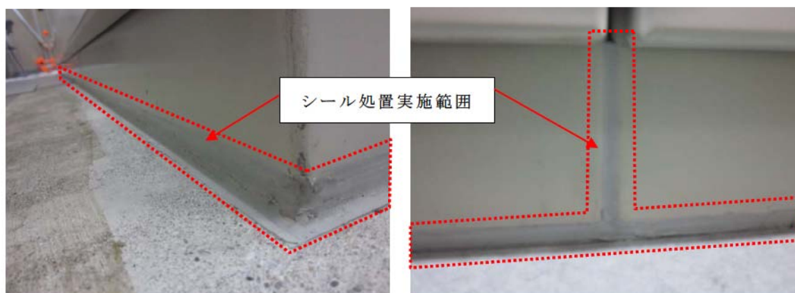
参考資料 1 添付 2 -図 1 電気盤下部へのシール処置状況（A/B17.8m 安全系計装盤室）
