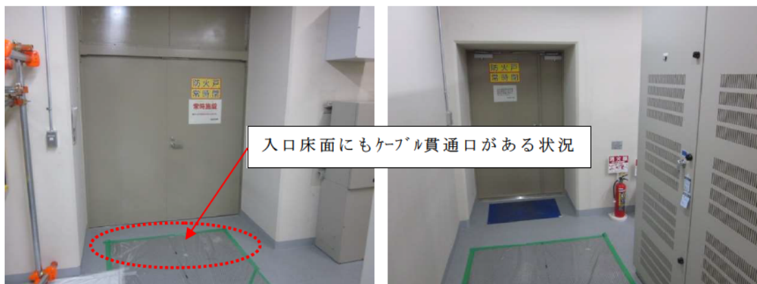
参考資料 1 添付 2-図 3 安全系計装盤室の 2 箇所の入口扉の状況
