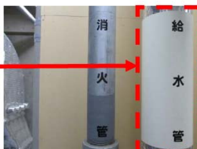
T. P. 14. 3m配管室
