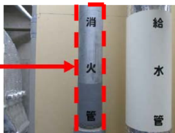
T.P. 14.3m配管室
