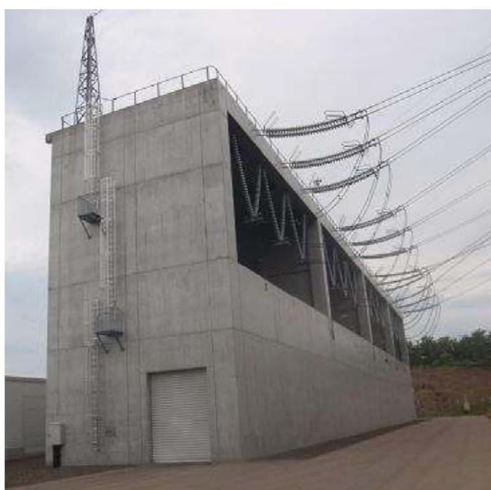
図 1 開閉所（遮風建屋）
