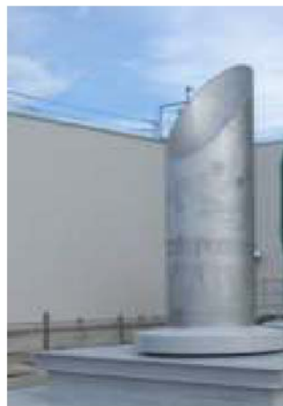
図3 主蒸気安全弁（排気管）の設置状況
