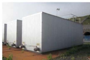
屋外給水タンク
