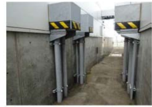
ケーブル引き込みボックス
