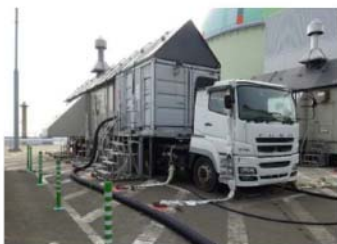
代替非常用発電機
