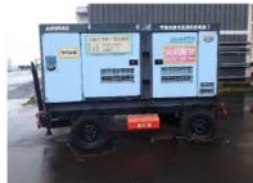
可搬型直流電源用発電機
