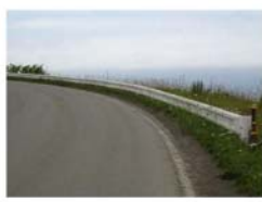
ガードレール
