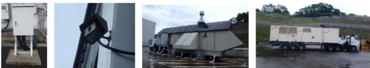
盤 スピーカー 代替非常用発電機 発電機車
