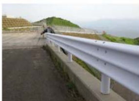
ガードレール
