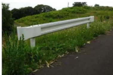
ガードレール
