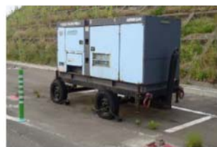
可搬型直流電源用発電機
