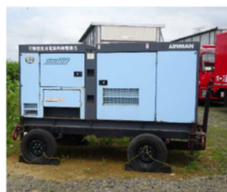
可搬型直流電源用発電機
