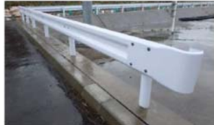
ガードレール
