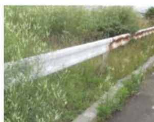
ガードレール
