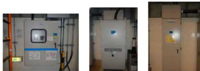
④補助建屋クレーン主電源盤 ⑤管理区域照明用変圧器 ⑥管理区域照明用分電盤
