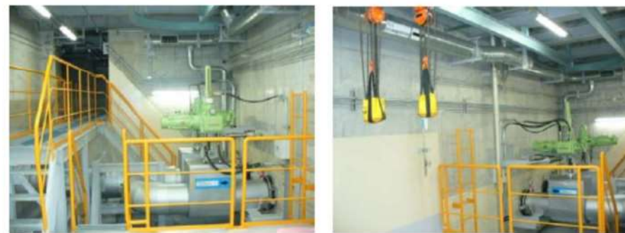
図-6 A,B-安全注入ポンプ再循環サンプ側入口C/V外側隔離弁周辺の状況
