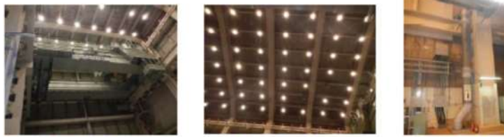
①補助建屋クレーン ②SF 6 天井照明 ③空調ダクト
