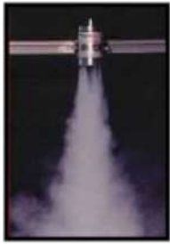
消火剤放出時の様子
