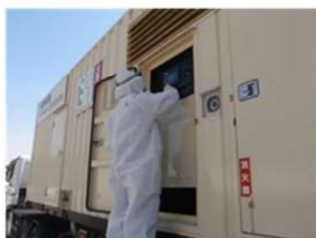
可搬型代替電源車起動 (タイベック+全面マスク)
