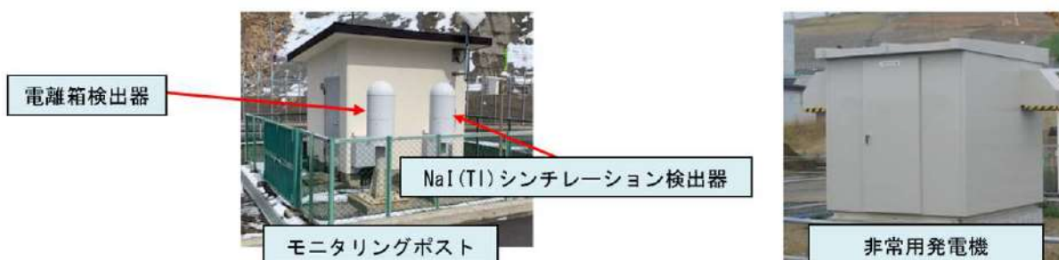
図2 モニタリングポストの設置状況
