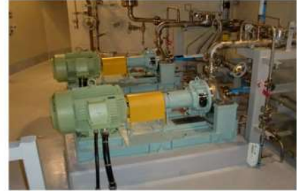
格納容器冷却材ドレンポンプ
