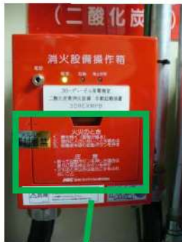
写真⑤ 消火設備操作箱
