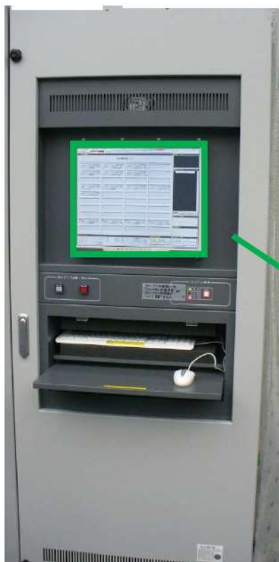
写真④ 中央制御室 総合操作盤
