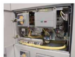
コントロールセンタ
