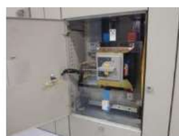
直流コントロールセンタ
