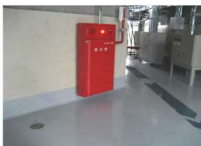
図-15 屋内消火栓
