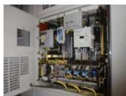
パワーコントロールセンタ
