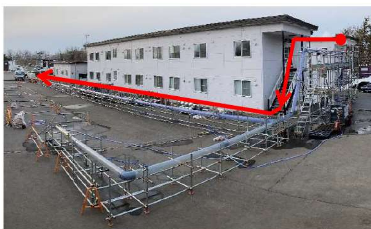
添付 6-3(1) 図 モックアップ試験装置の全景 (ルート 1)
