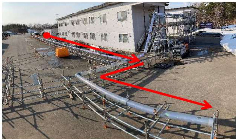
添付 6-3(3) 図 モックアップ試験装置の全景 (ルート 3)
