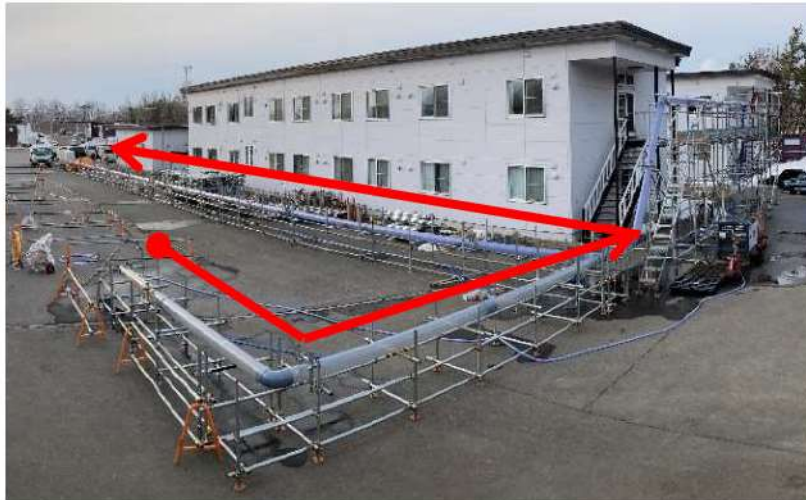
添付 6-3(2) 図 モックアップ試験装置の全景 (ルート 2)
