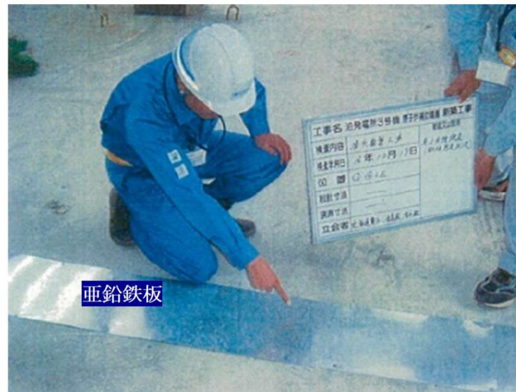
添付1-6図 集水管及びサブドレンの敷設状況写真(泊3号炉建設時)
