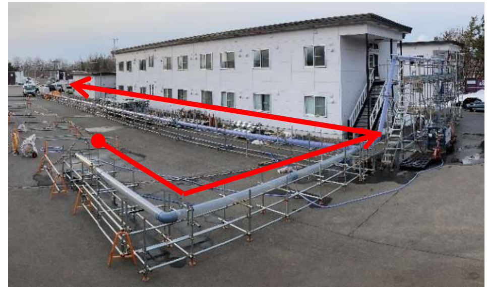
添付6-3(2) 図 モックアップ試験装置の全景(ルート2)
