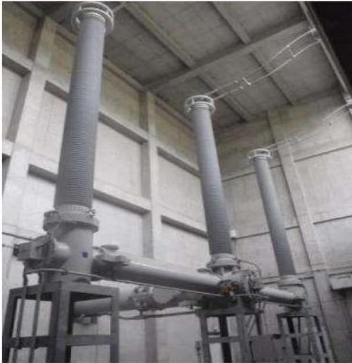
275kV ブッシングの外観
