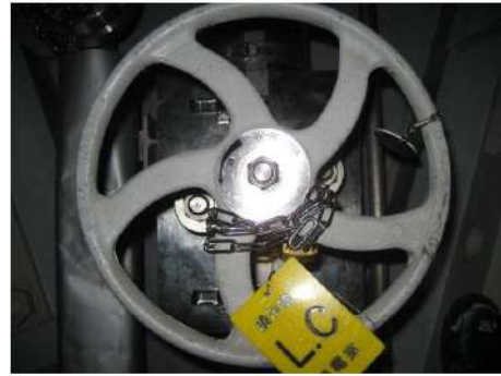
図2 弁施錠状態の例の写真
