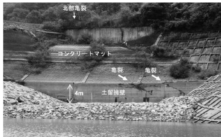
写真-2 土留擁壁への亀裂 右端のリップアップの盛り上がりは施工当時のもの。
