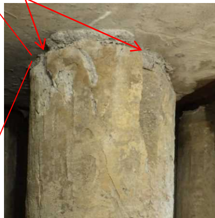
図44 No.8杭頭部の損傷状況
