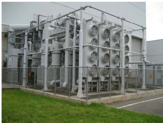
第1図 変圧器外観
