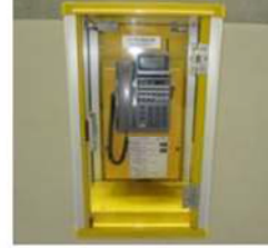
運転指令設備 (ハンドセットステーション)
