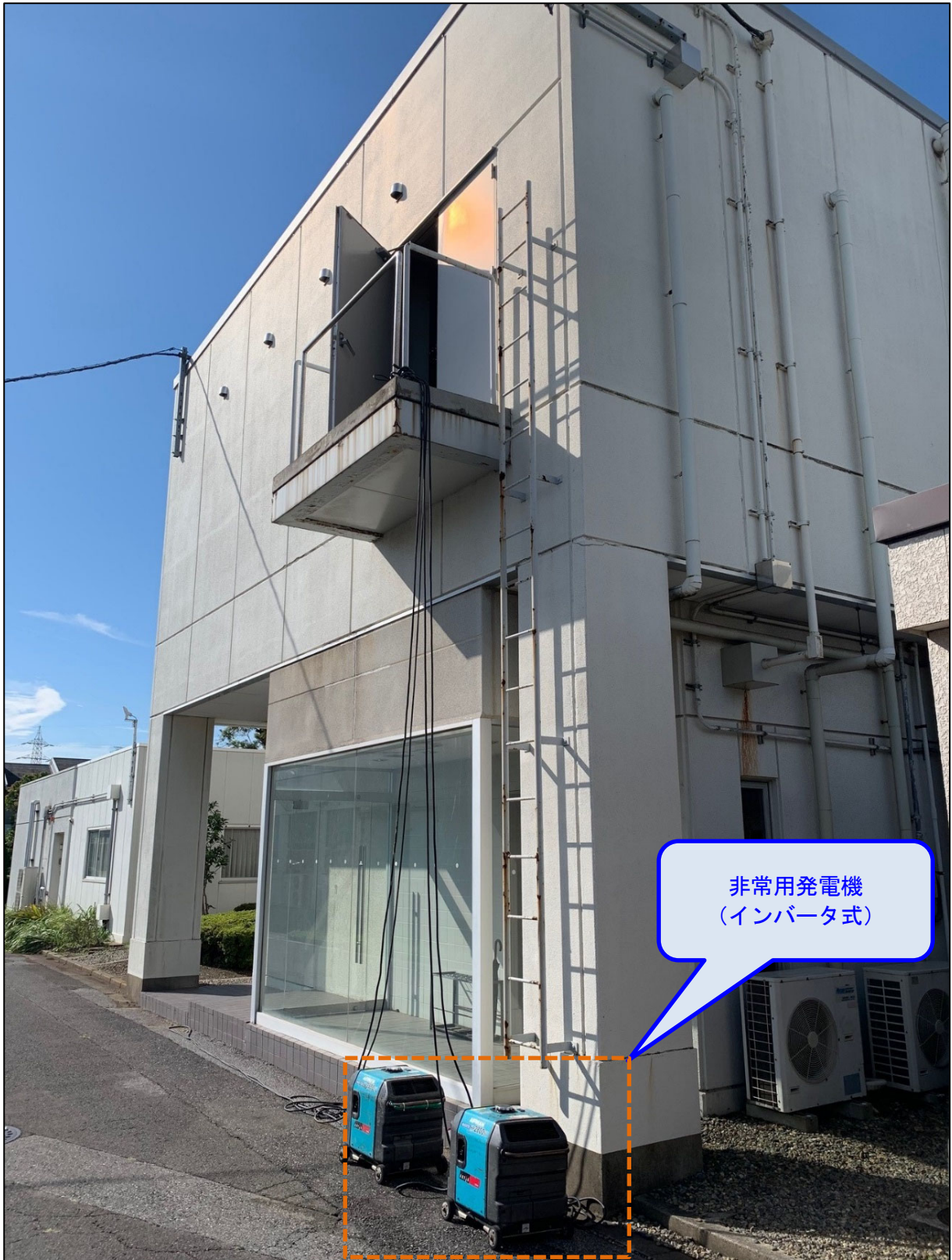
図 12 モニタリングポストデータオンライン収集システムを発電機等で運用した時の様子
